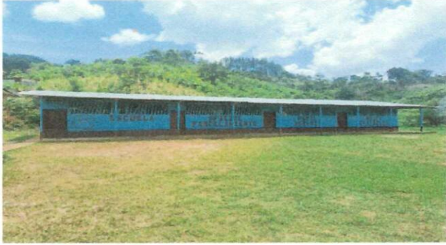
Foto1: Se observa el material no adecuado de la escuela.
