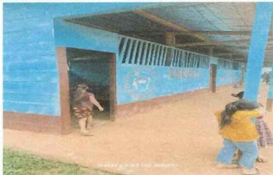
Foto 5: El área de ventilación está deteriorado.
