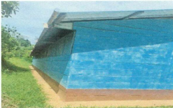
Foto 3: Se observa la mala condición de los tubos que conduce el agua.
