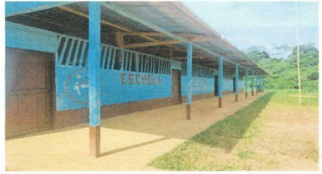
Foto 2: Se observa la falta de ventanas de las aulas.
